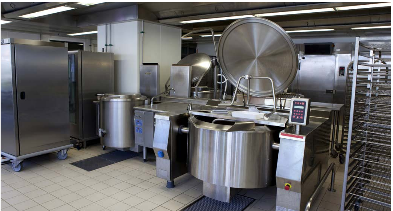
Abb. 37 Der Einsatz von Geräten mit Fettdampf und Wasseranfall macht eine Abluftanlage erforderlich.
