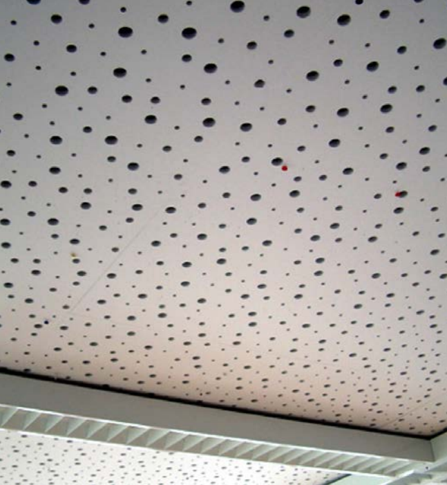
Abb. 13 In der Regel reicht schon eine schallabsorbierende Deckenfläche mit einem guten schallabsorbierenden Material um die raumakustischen Verhältnisse zu verbessern.
