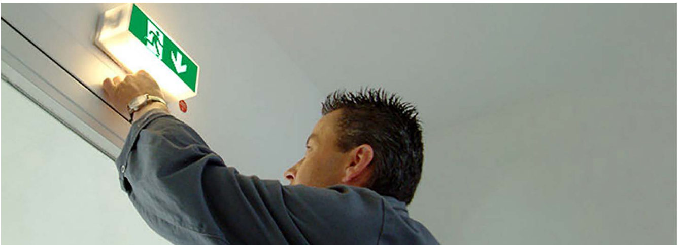
Abb. 69 Neben gut planbaren Instandhaltungsaufgaben gibt es – gerade in alten Schulgebäuden – häufig spontan anfallende Reparaturen.
