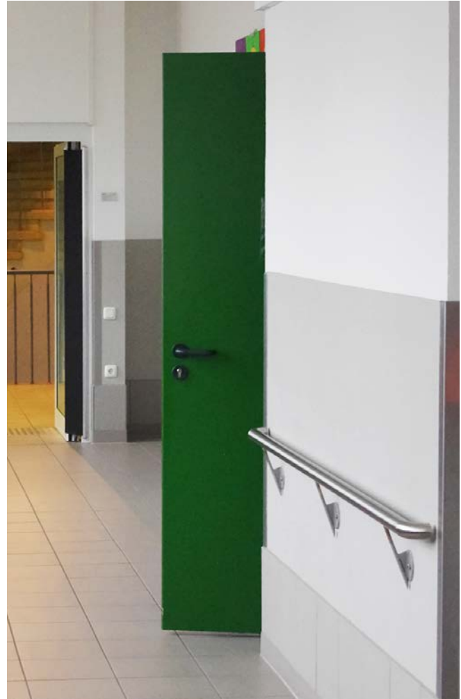
Abb. 6 Türen müssen so eingebaut und angeordnet sein, dass Vorbeilaufende durch nach außen aufschlagende Türflügel nicht gefährdet werden.
